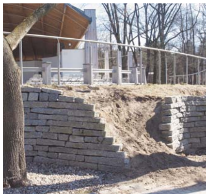
Murek wokół widowni wymaga pilnej naprawy
