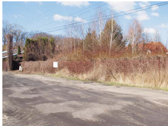
Niektórych dziur w nawierzchni ul. Grzybowskiej nie sposób ominąć nie uszkadzając zawieszona samochodu
