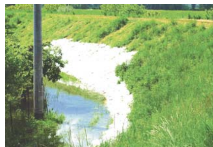
Pomimo, że woda zaczęła opadać, wał w Dębówce przesiąkał jeszcze 24 maja
